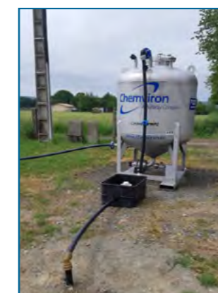
Filtre provisoire à charbon actif pour essais—Champagnac
